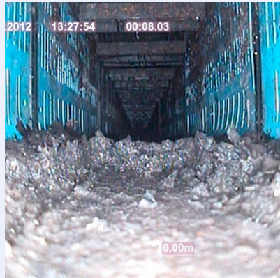
Canal de sédimentation durant son fonctionnement.
